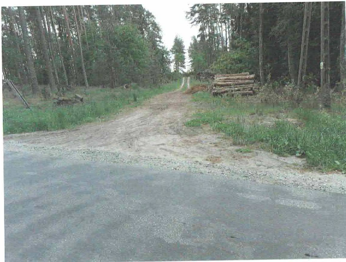
Zjazd z drogi powiatowej 2606G przewidziany do remontu / czerwiec 2019 /
