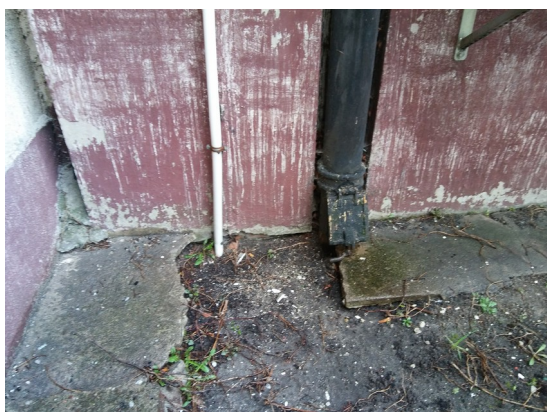
Widok zniszczonych opasek betonowych (tam, gdzie one są)
