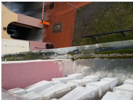
Widok zniszczonych obróbek blacharskich na gzymsach
