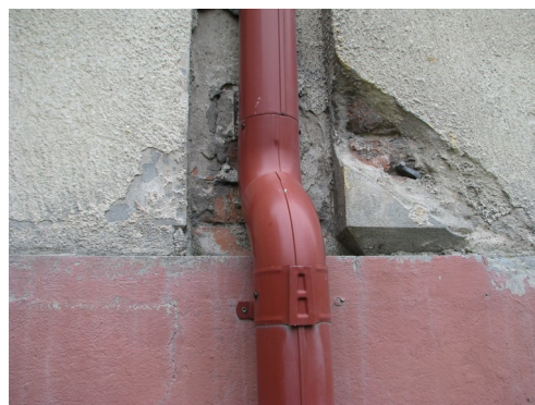
Widok stanu tynków przy rurach spustowych
