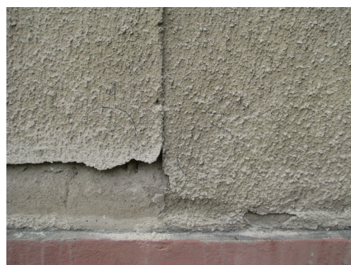
Widok uszkodzeń tynków przy cokole
