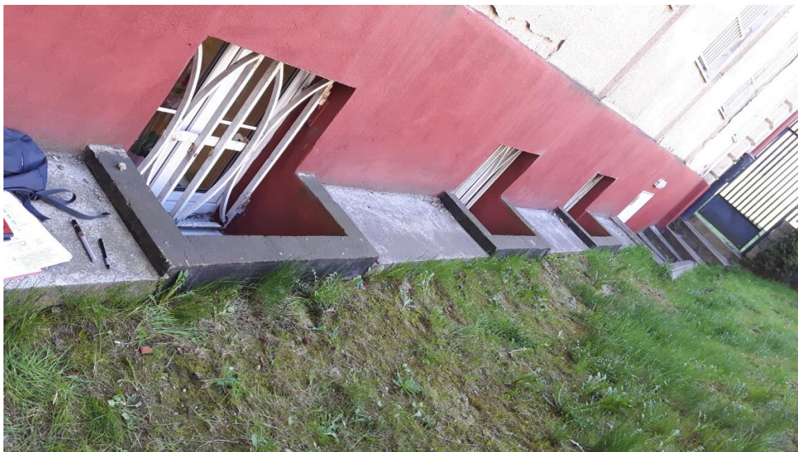
Elewacja skrzydła północnego- odspojenia wtórnej wyprawki tynku
