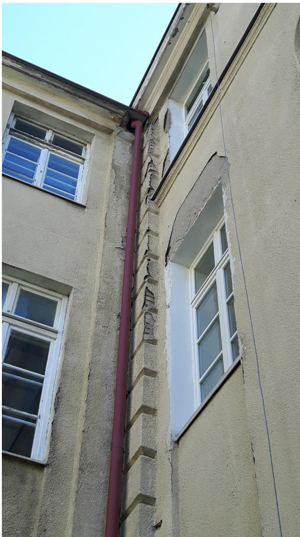
Elewacja skrzydła północnego – odspojenia wtórnej wyprawki nakrapianej i tynków na boniach
