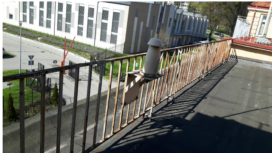
BOCZNE BARIERY STROPODACHU: STAN ZŁY, MOCNO SKORODOWANE. BARIERKI WOKÓŁ KOPUŁY PO REMONCIE, ZABEZPIECZONE SREBRNĄ FARBĄ.
