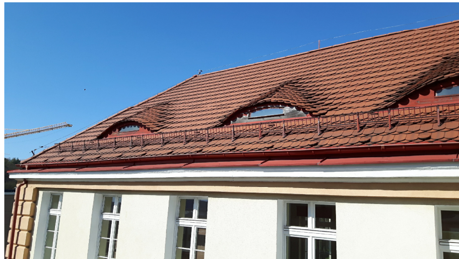
ELEWACJE NAD STROPODACHEM: STAN TYNKÓW ŚCIENNYCH OGÓLNIEM DOBRY, Z MIEJSCOWYMI USZKODZENIAMI I NIEFACHOWYMI UZUPEŁNIENIAMI PRZY OSADZNIU PARAPETÓW. OKNA W CAŁOŚCI WYMIENIONE NA NOWE.
