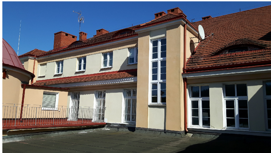
GZYMSY: POMALOWANE, JEDNAK PODCZAS REMONTU NIE WYKONANO WZMOCNIENIA I KONTUROWANIA WYPRAWEK GZYMSÓW, OBECNIE CZĘŚĆ GZYMSÓW OSYPUJE SIĘ.
