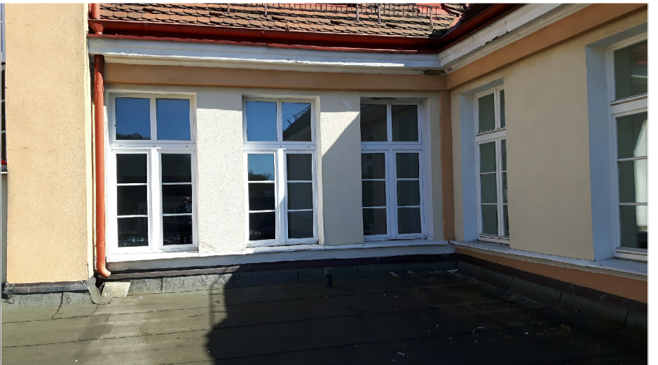
MIEJSCOWE USZKODZENIA: PRAWDOPODOBNE ZAWILGOCENIE SPOD NIESZCZELNEJ OBRÓBKI BLACHARSKIEJ OKAPU DACHU - TYNKI ODSPAJONE Z NADPROŻA OKIENNEGO I GZYMSU.
