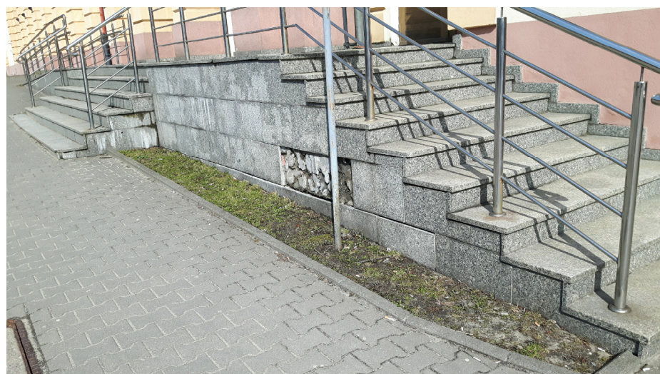
SCHODY W OKŁADZINIE GRANITOWEJ: STAN ZŁY, KLAWISZUJĄCE I ODPADAJĄCE OKŁADZINY LICA I SKRAJU PODESTU.
