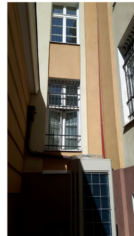
NOWE KRATY Z ELEMENTAMI KUTYMI - DOBRY STAN, Z DROBNYMI ŚLADAMI KOROZJI.
