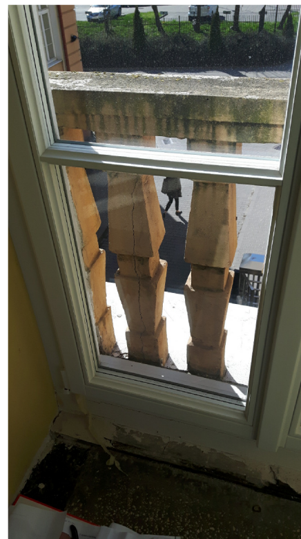
TRALKI PORTFENETRÓW - ZŁY STAN WYKWITY MIKROORGANIZMÓW NA NIEZABEZPIECZONYCH PORĘCZACH I DROBNE SPĘKANIA BETONU.
