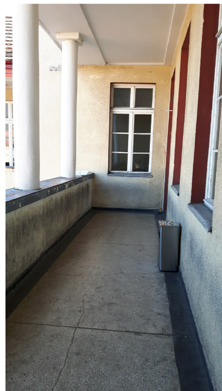
POSADZKA LASTRIKO (II PIĘTRO) - ŚREDNI STAN, SPĘKANIA. TYNKI WEWNĘTRZNE SILNIE ZABRUDZONE. CZAPA MURKU -PŁYTKI CERAMICZNE POKRYTE ŁUSZCZĄCĄ SIĘ FARBĄ.
