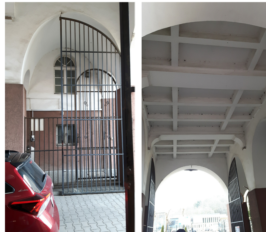
PRZEJAZD BRAMNY - STAN OGÓLNY DOBRY. TYNKI NA STROPIE KASETONOWYM W DOBRYM STANIE, JEDNAK ZANIECZYSZCZONE WE WGLĘBIENIACH. TYNKI STREFY COKOŁOWEJ W STANIE DOŚĆ DOBRYM, ZANIECZYSZCZONE W STREFIE DOLNEJ
