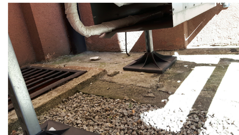
OPASKA BETONOWA PRZY CENTRALI KLIMATYZACYJNEJ - ZŁY STAN TECHNICZNY
