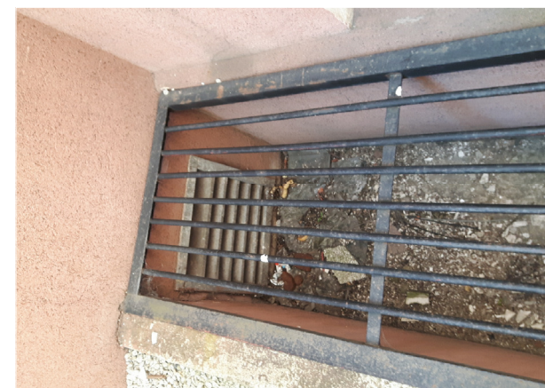
NOWA STUDZIENKA WENTYLACYJNA DOBUDOWANEGO WEJŚCIA- DOBRY STAN, KRATA DO ZABEZPIECZENIA ANTYKOROZYJNEGO, DNO STUDNI DO OCZYSZCZENIA
